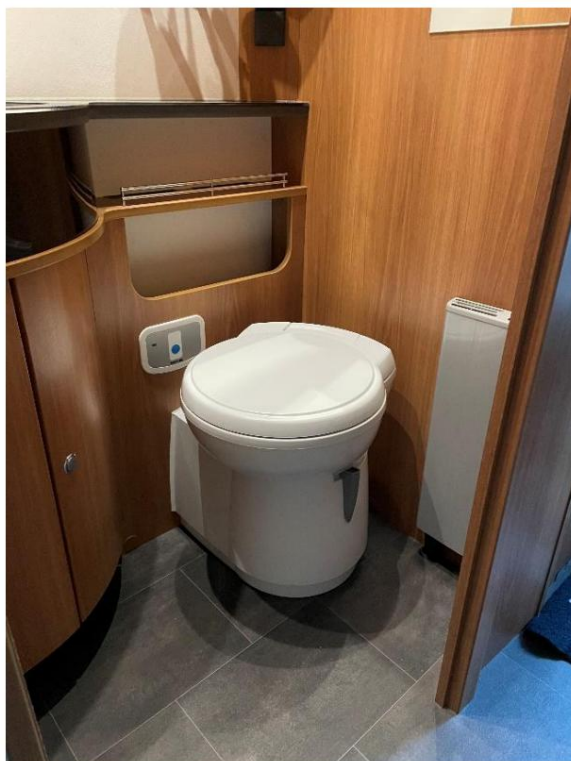
Původní stav s nainstalovanou řadou Thetford C263-S
